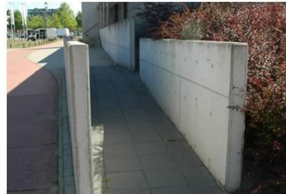
Aan open zijden (geen wanden) van de helling is een afrijdbeveiliging of rand aanwezig. – jeugdhuis rondpunt Genk
