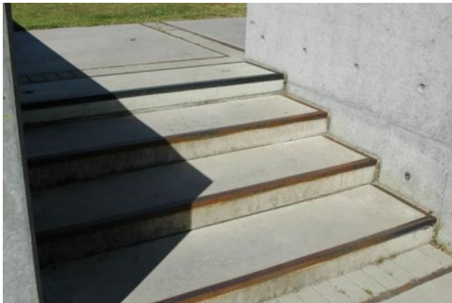
Jeugdhuis Genk: De trap werd voorzien van een goede contrastmarkering op elke trede.
