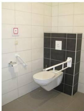
Goede contrasten, bvb tussen de toestellen en de wand, en een goede verlichting is nodig. Voorzie in het aangepast toilet een (verlengde) toiletspot of zorg ervoor dat de voorzetwand stopt onmiddellijk na het ingebouwde spoelsysteem - Scouts Neerpelt (zowel een voorzetwand als een verlengde toiletspot omdat de voorzetwand niet stopt vlak na het toilet)
